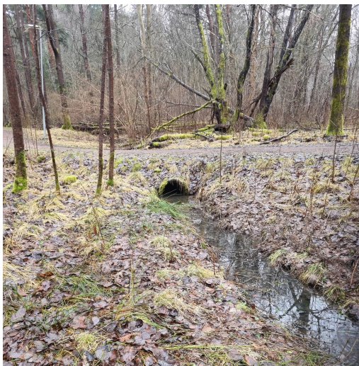
Figur 21 Befintlig trumma under den södra stigen belägen nedströms området som tillåts svämma över inom naturvårdsområdet. Den södra stigen höjs med cirka 1 meter som mest. Nya trummor anläggs utifrån dikeshöjd (Sweco).
